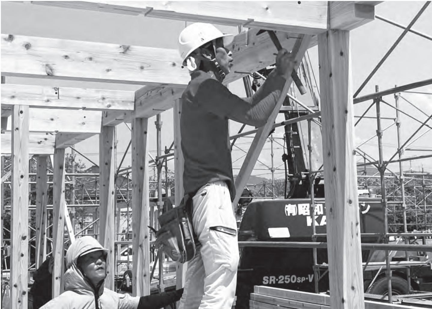
連日の猛暑、台風の接近など大変な状況の中での建設作業
